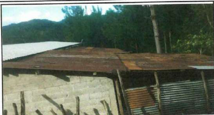
Foto1: el estado de la laminas esta en mal estado por tal razon es necesario el cambio de laminas por nuevas y tambien el cambio de la estructura metalicas para darle un mejor aspecto al corredor de la escuela.
