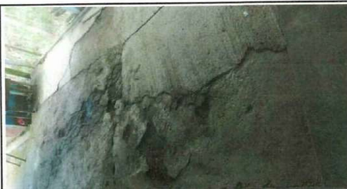
Foto 8: la plancha de concreto del patio esta en pesimas condiciones siendo muy necesario la reparacion de la misma para que los niños tengan un espacio digno.
