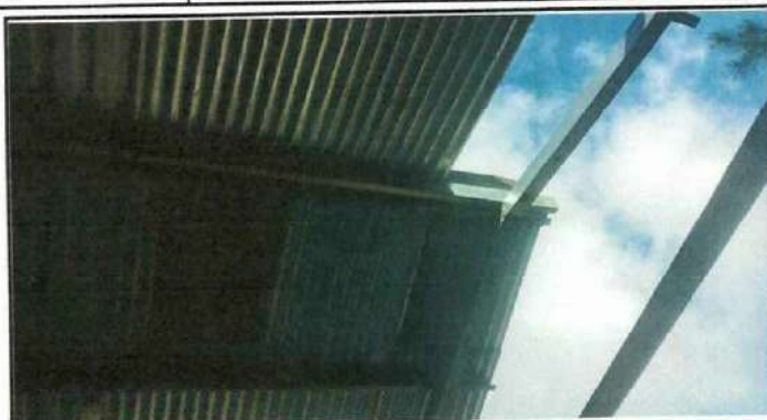
Foto 2: las condiciones en que se encuentran las laminas y capote en esta parte del establecimiento por las condiciones admosfericas, siendo necesario el cambio por nuevas.
