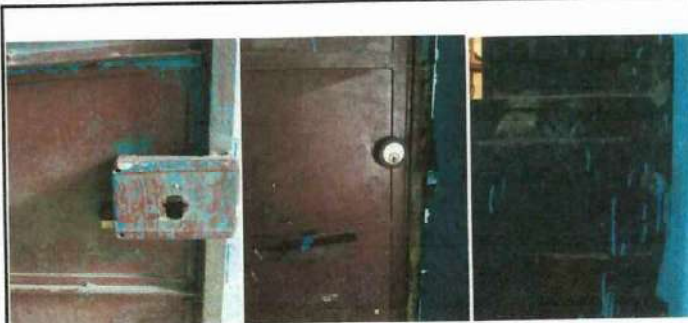
Foto 4: las chapas de primero primaria, cuarto y la bodega estan en muy malas codiciones siendo muy necesario reemplazarlos en nuevos.
