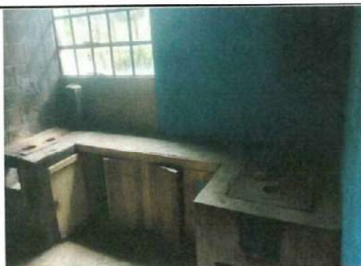
Foto 10: el estado de las planchas de metal estan muy deterioradas y en malas condiciones siendo necesario la sustitucion tambien la chimenea.
